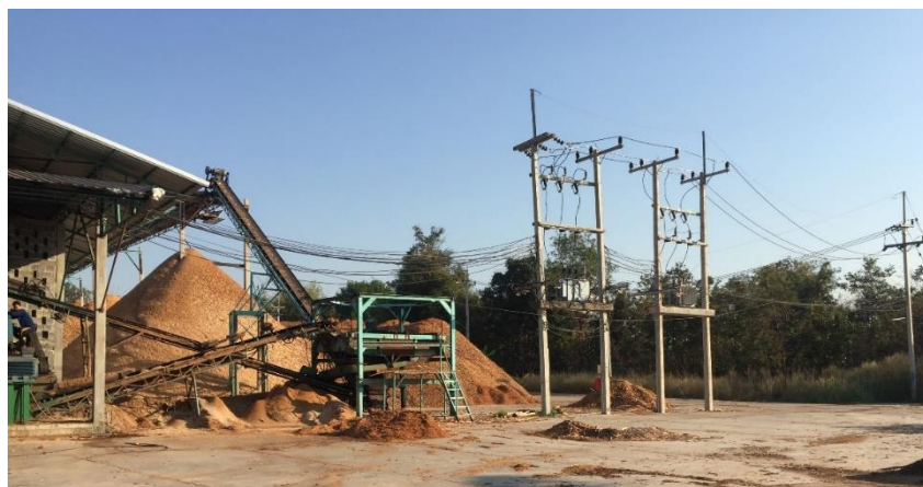
รูปที่ 3 บริเวณระบบผลิตชีวมวลคุณภาพดีสลับ และบริเวณที่ติดตั้งหม้อแปลงไฟฟ้า
